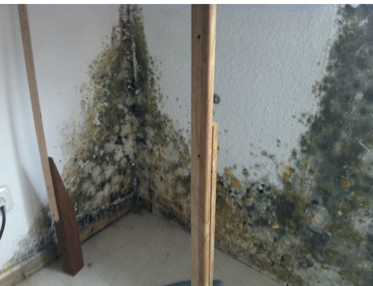
Massiver Schimmelschaden hinter einer ausgebauten Küchenzeile
