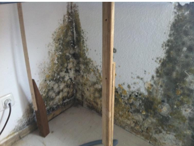
Massiver Schimmelschaden hinter einer ausgebauten Küchenzeile
